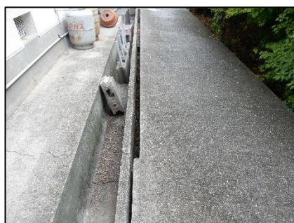
地盤の傾き・沈下
