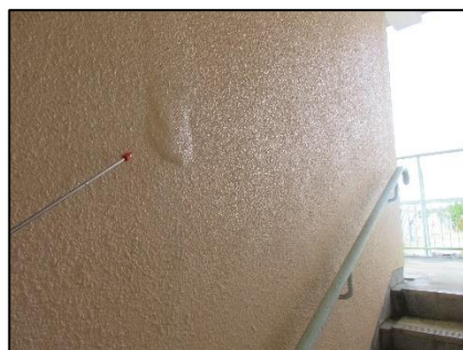
外壁の塗膜の膨れ
