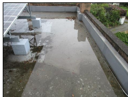
屋上の排水不良
