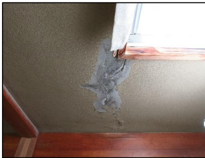
亀裂による漏水
