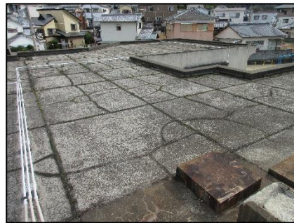
屋上アスファルト防水の亀裂
