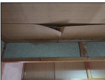
天井の雨漏れ・漏水
