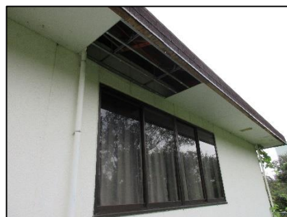
軒天ボードの脱落
