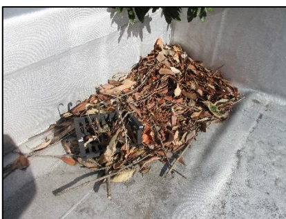
屋上排水口の詰まり
