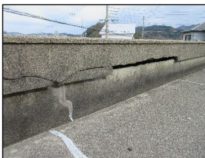
屋上笠木・パラペットの破損
