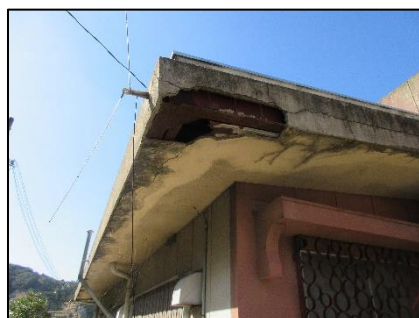
軒天コンクリート片の脱落・ 露筋
