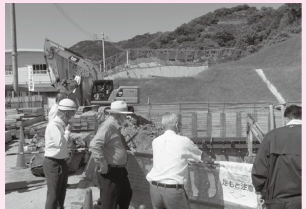
栖原ポンプ場
