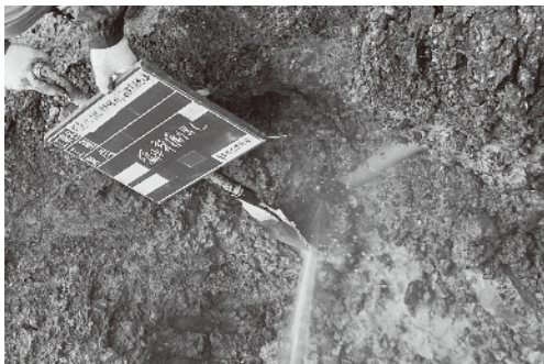
昨年発生した漏水現場
