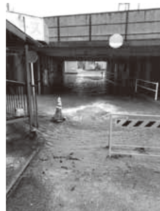
JR 高架下道路の冠水状況
