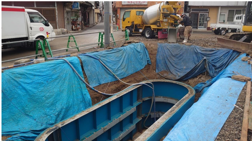
状況を示す写真や資料等 本町区への防火水槽設置
