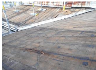
屋根野地板に菱茸痕跡
